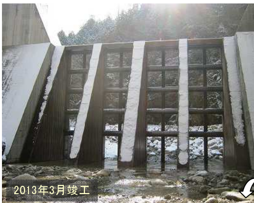
④戸坂1号砂防堰堤 国)太田川河川事務所 ■開口部高さ: 2.0m ■水通し幅 : 12.0m ■最大礫径 : 0.4m
