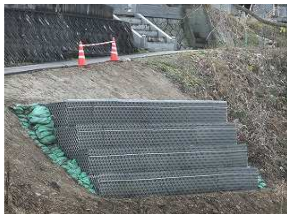
■新潟県小千谷市役所/上片貝5号線災害復旧 ブロックノン(BLN): H=3.0m、L=7.0m
