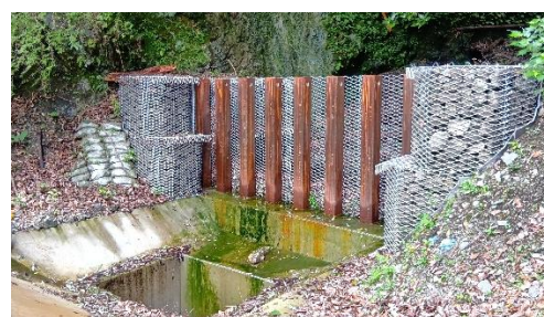
写真-2 呑口閉塞対策の事例
