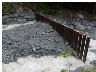
設置完了から 10 日後
