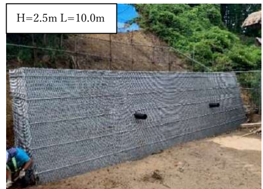
事例-1 青森県 青函トンネル付近
